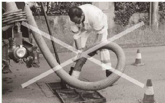
AUTOBOTTE ESPURGO + CANAL JET (sistema sconsigliato)
